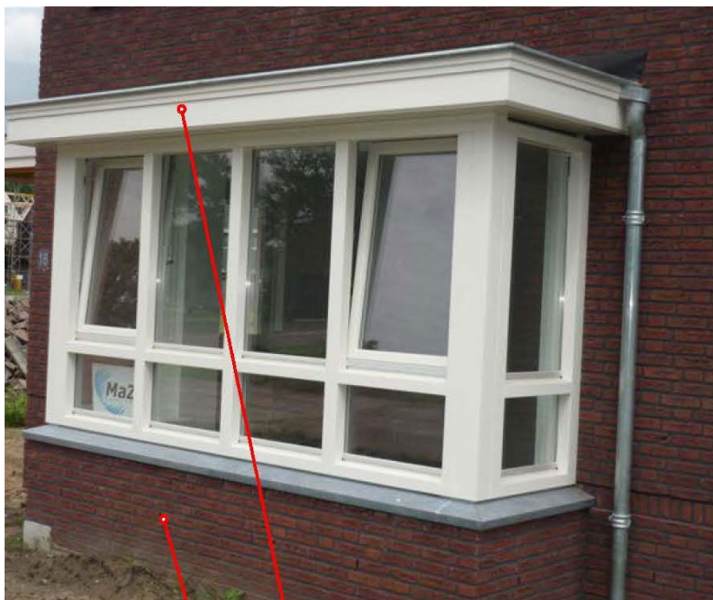
Borstwerking in metselwerk.
